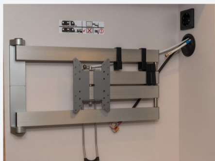
TV-Vorbereitung mit Steckdose und Kabelverlegung/-durchführung
