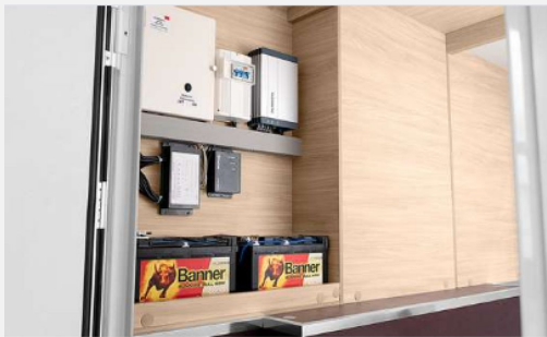
Organisierte Bord-Elektrik & Servicebox
