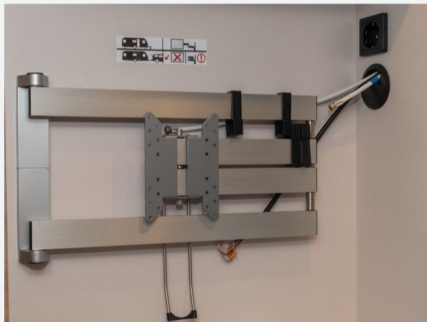
TV-Vorbereitung mit Steckdose und Kabelverlegung/-durchführung
