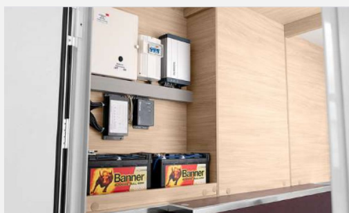
Organisierte Bord-Elektrik & Servicebox
